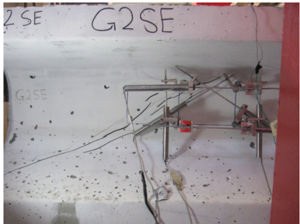
(d) Shear crack pattern before failure
